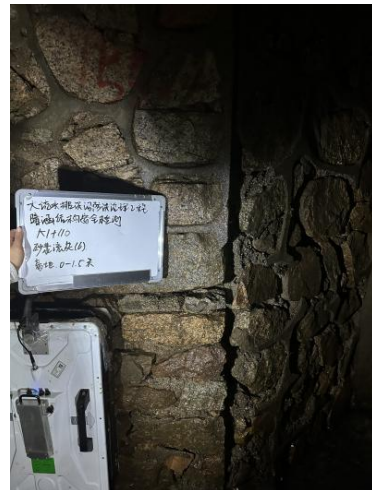
现状浆砌石挡墙开裂
