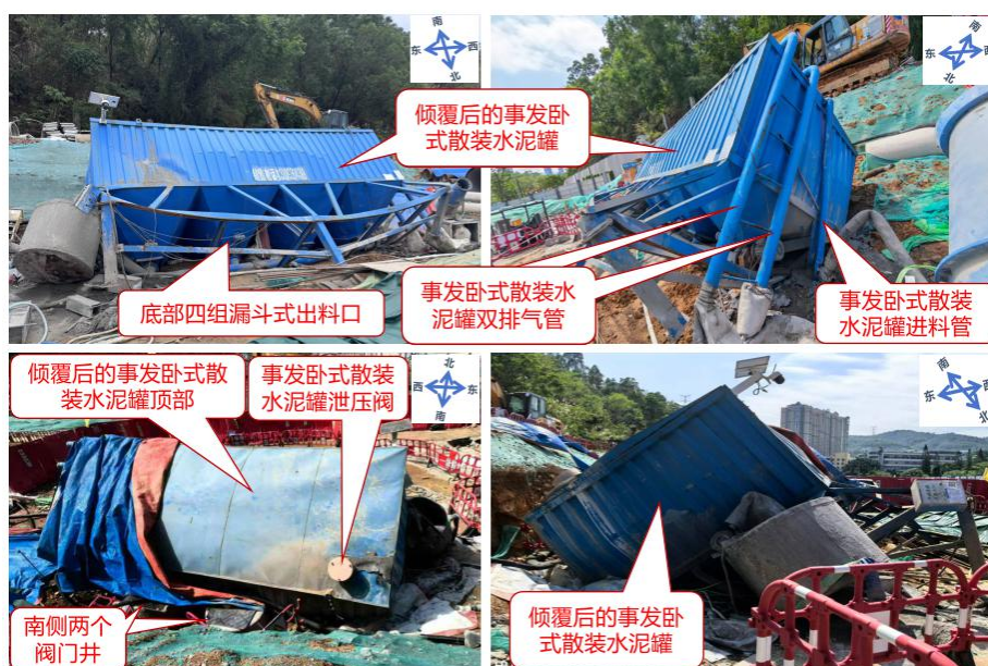
图 15 事发卧式散装水泥罐倾覆状况勘查图
