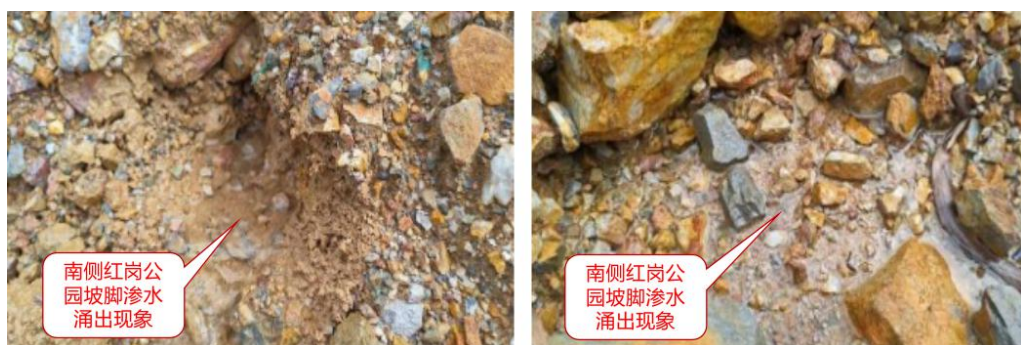
图 13 南侧红岗公园坡脚处渗水涌出现象勘查图
