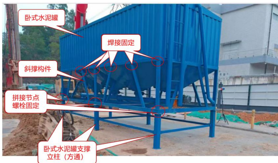
图 16 事发卧式散装水泥罐支撑体系勘查图
