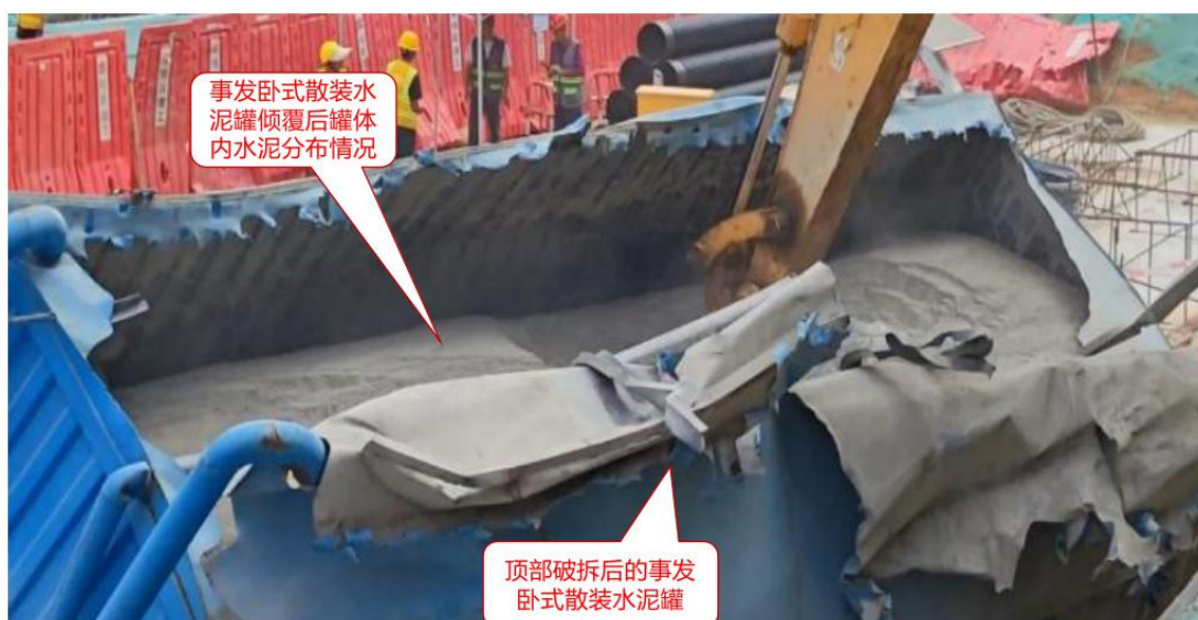
图 20 事发卧式散装水泥罐罐体内水泥分布情况勘查图
