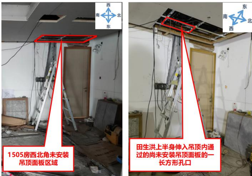
图 6 事发时 1505 房西北角尚未安装吊装面板区域图
