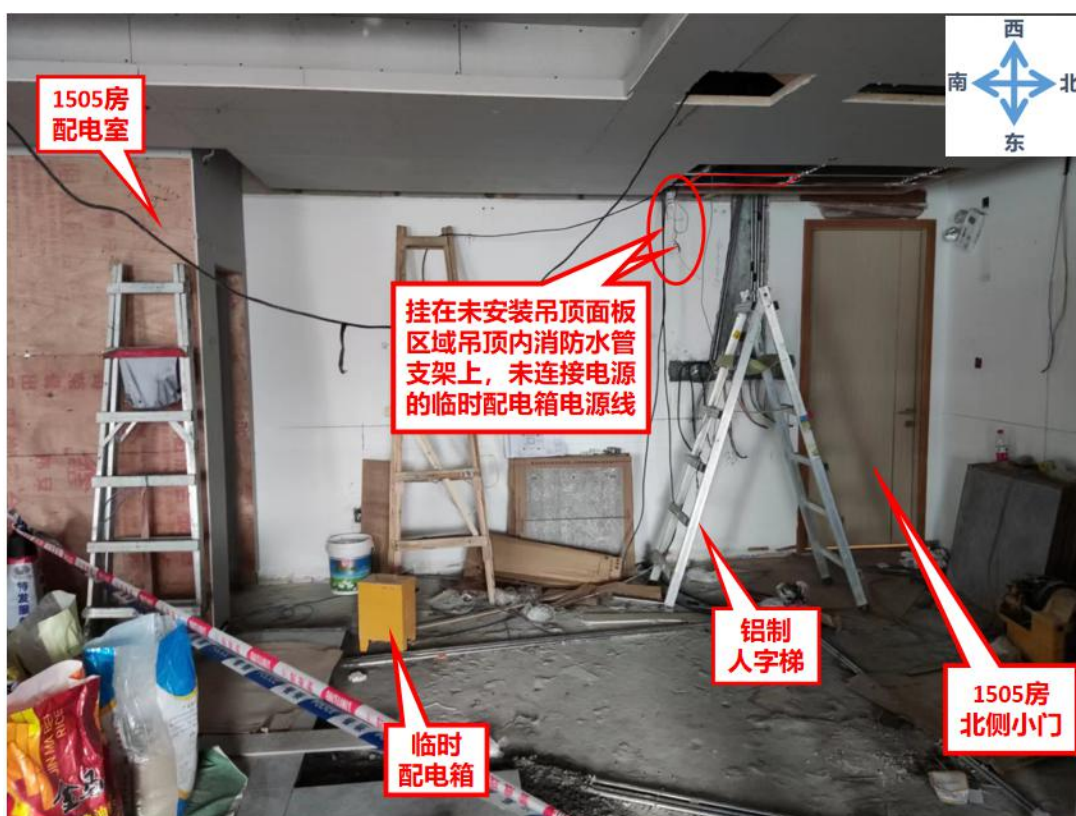
图7 事发时1505房西北角尚未安装吊装面板区域图
