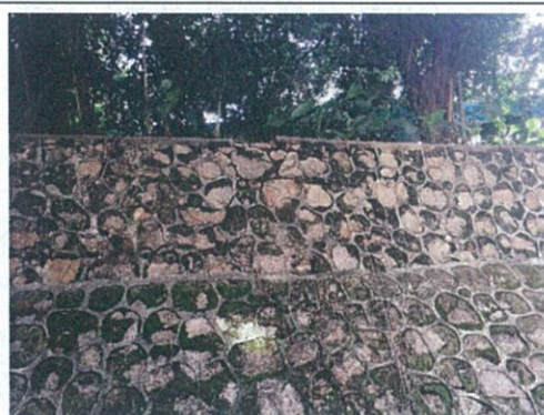
照片 4 挡墙顶部破损
