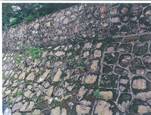
照片 2 墙体砂浆掏空
