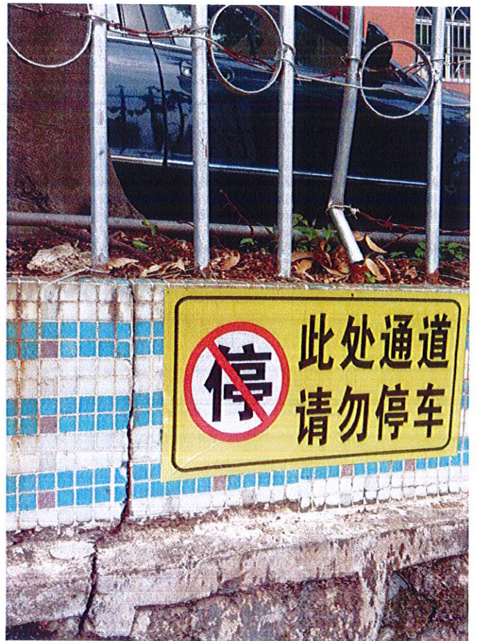
受树根引起造成裂缝
