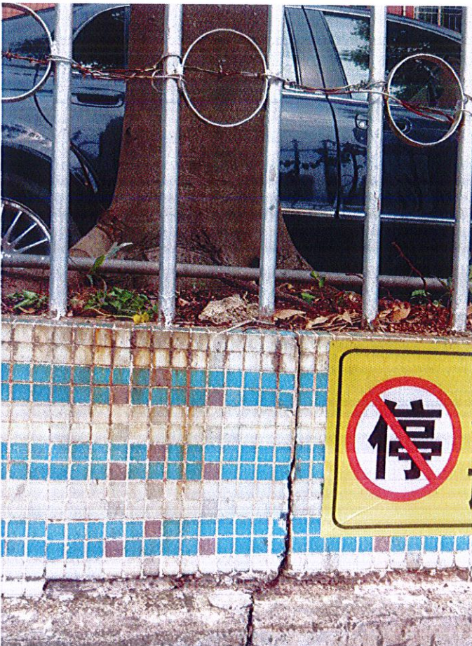
受树根引起造成裂缝
