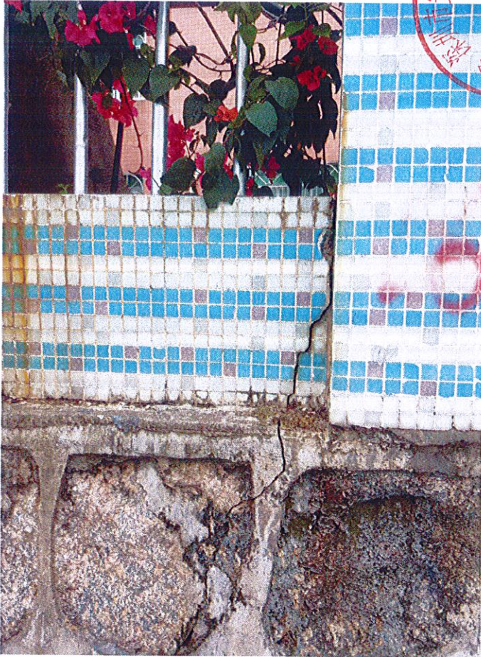
受树根影响造成裂缝
